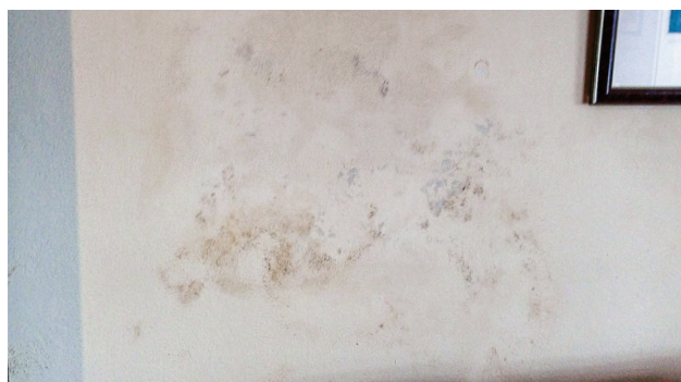
Deutlich sichtbarer Schimmelbefall
